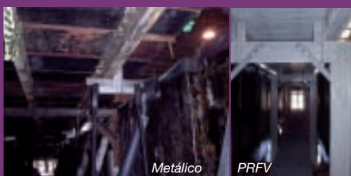
Figuras 9 y 10. Soportes de pasarelas en la zona de celdas
