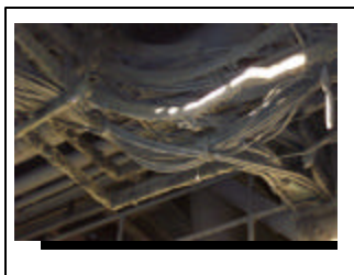
Ejemplo de bandejas que ya no cumplen su función por la corrosión
